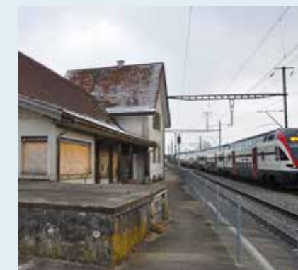
Sanierungsbedürftig: Bahnhof Bernrain
